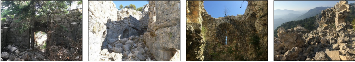
Şekil 4. Duvar ve örtü kayıpları
