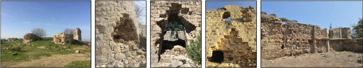
Şekil 5. İnsan etkisiyle meydana gelen yapısal sorunlar
